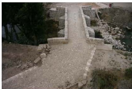
Año 1994. Obras de Restauración. Fotos facilitadas por el arqueólogo E. Cristóbal Villanueva
